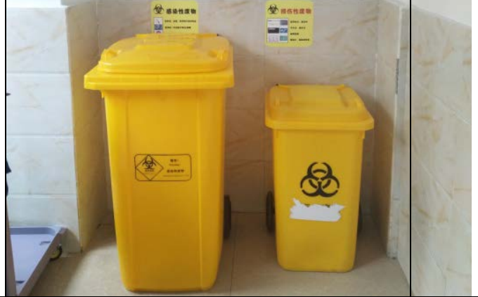
图1-12 医疗废物暂存间内部4
