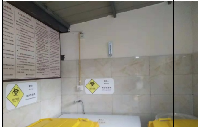
图1-10 医疗废物暂存间内部2
