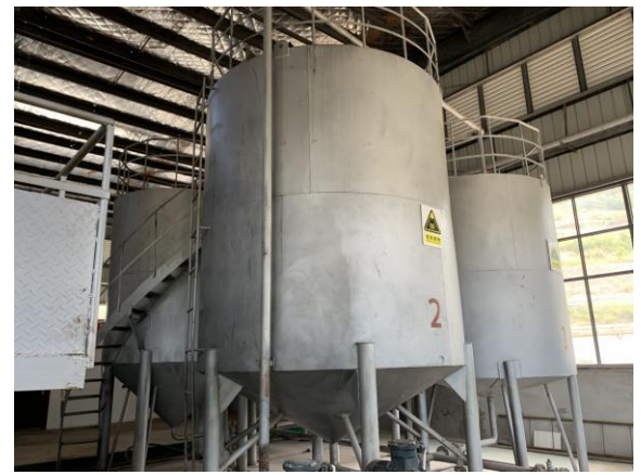
图 2-10：生产车间预处理区
