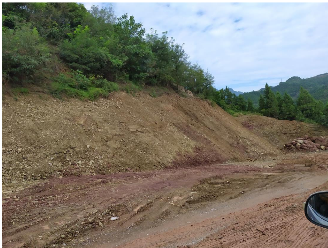
图 2.12-6 矿区道路边坡裸露地表
