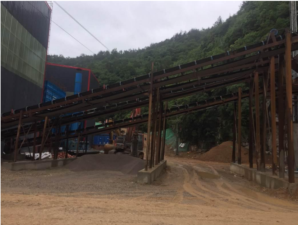
图 5-9 未封闭的皮带输送系统①
