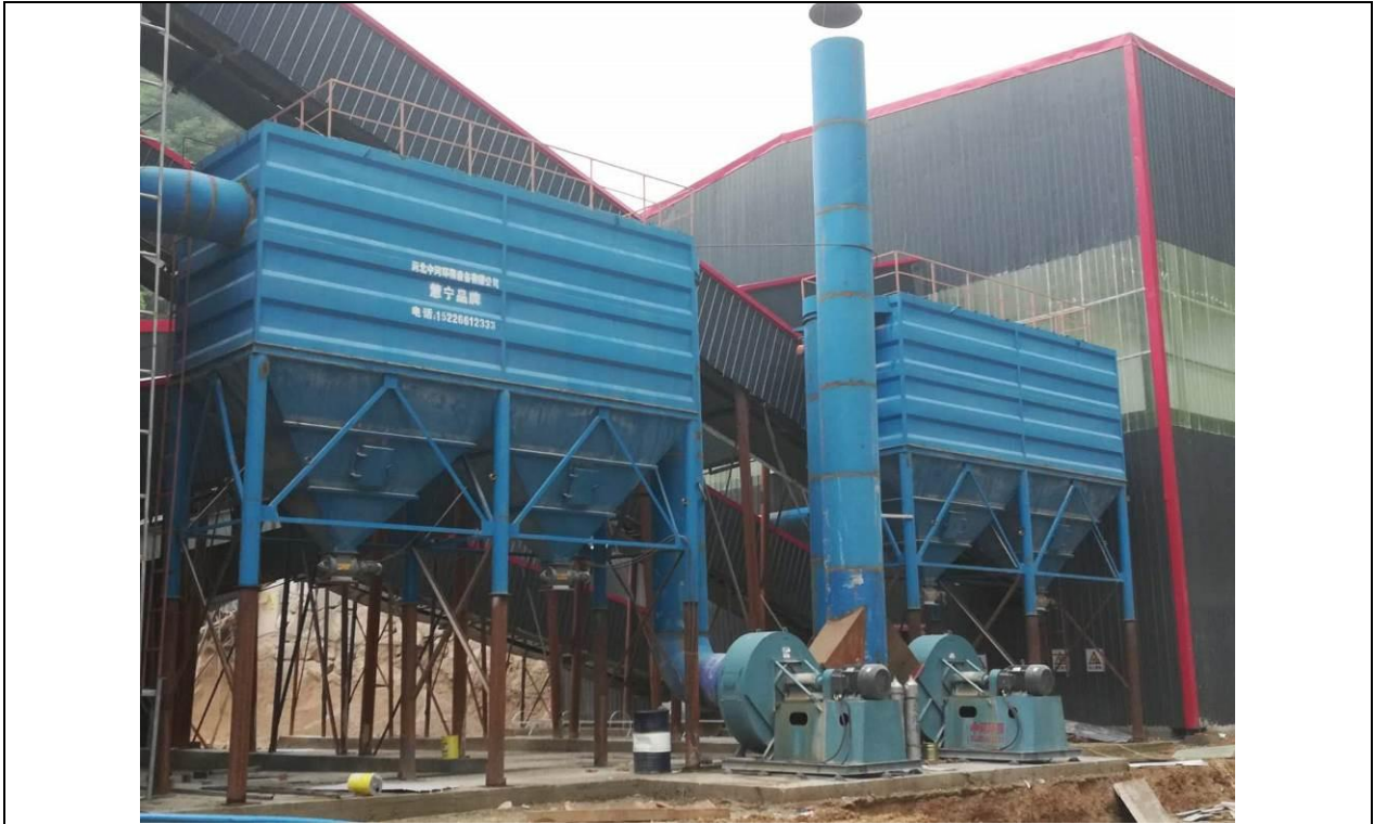
图 5-8 破碎生产线两套除尘器
