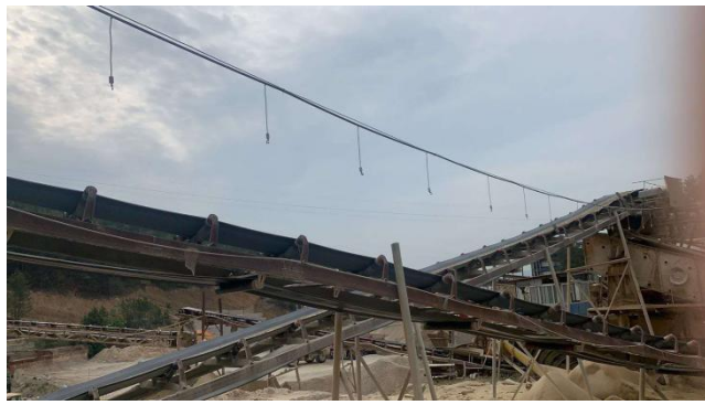
现状喷淋设施
