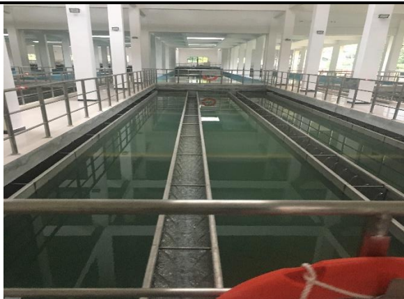
机械混合-折板絮凝-平流沉淀池叠清水池
