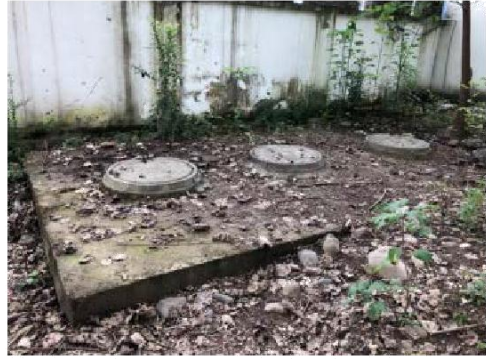
办公楼化粪池
