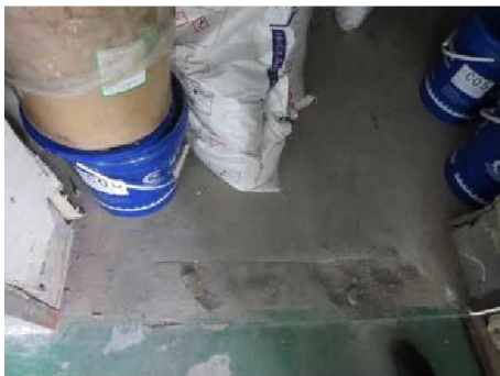
危废间围堰缺口
