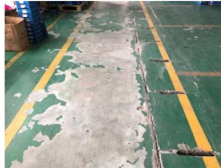
环氧地面破损
