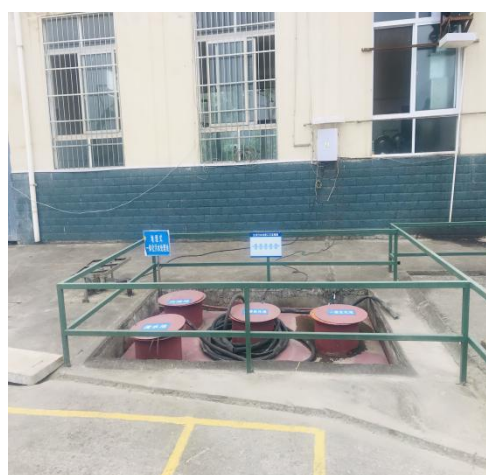
地埋式一体化污水处理池
