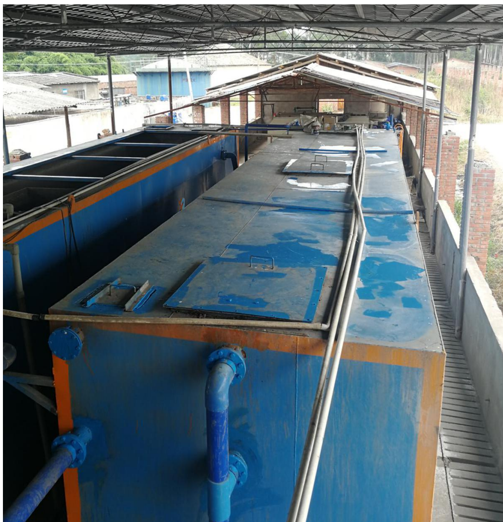
德康石埡种猪场污水处理站主体设施（一体化）
