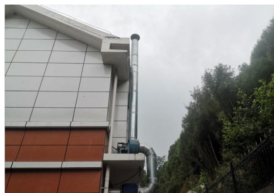
油烟净化设施及排气筒
