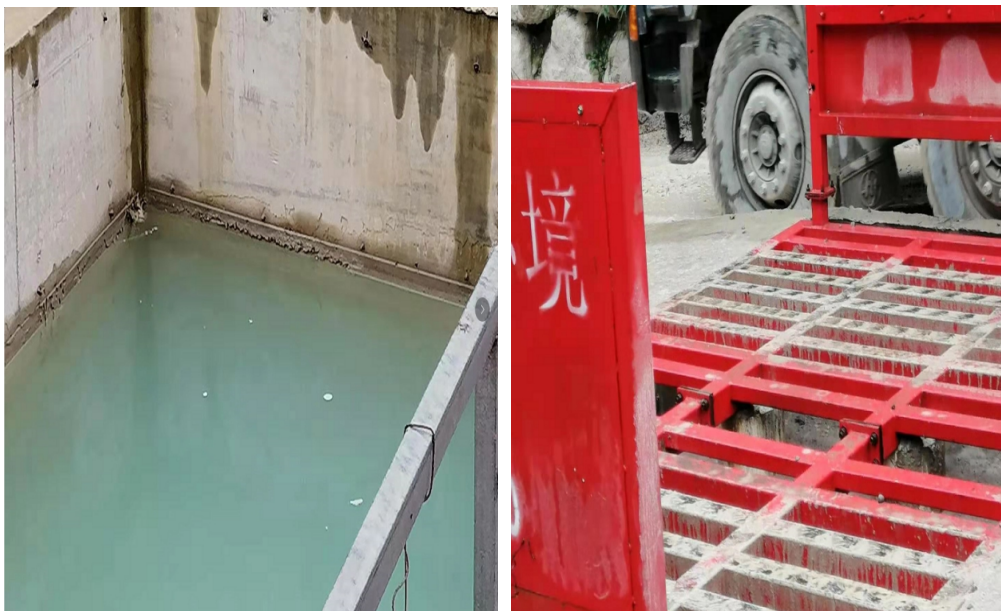
图 5-17 项目洗车废水收集沉淀池现状图
