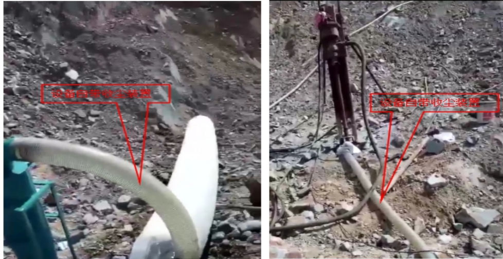
图 5-1 项目凿岩设备自带带捕尘装置
