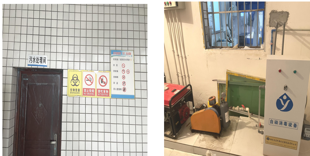
图 3.1-2 一体化污水处理站
