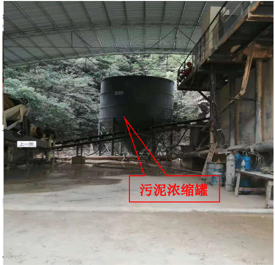
洗砂废水处理设施现状
