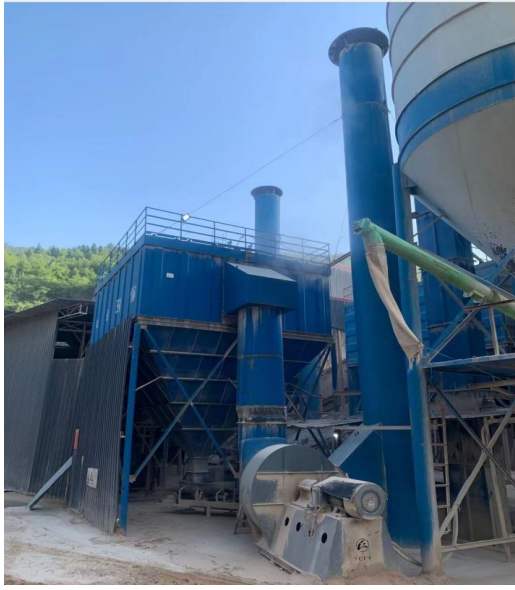
加工区除尘设施
