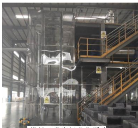
投料工段密闭收集照片
