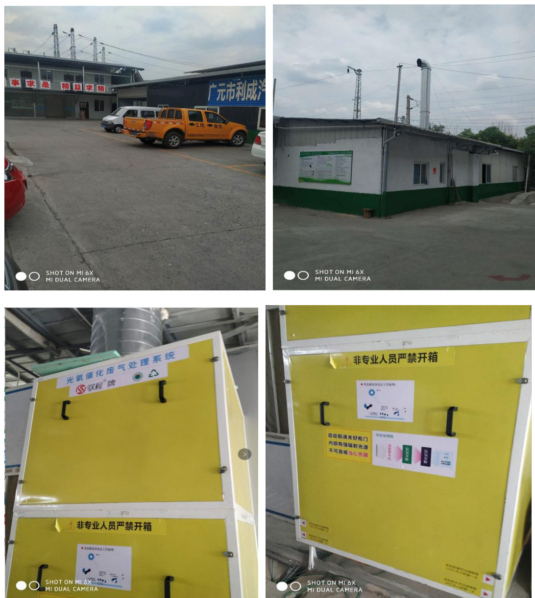
图5-6 项目喷漆房废气收集净化装置
