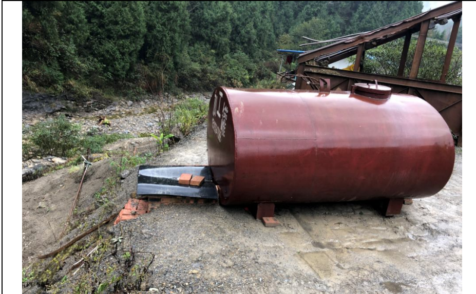
现有项目柴油储罐现状
