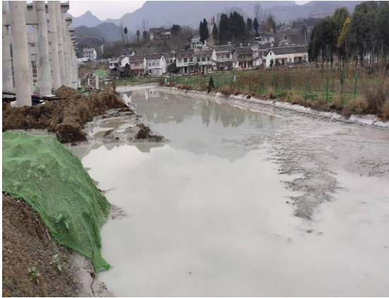
钢筋混凝土加工厂东侧大型沉砂池
