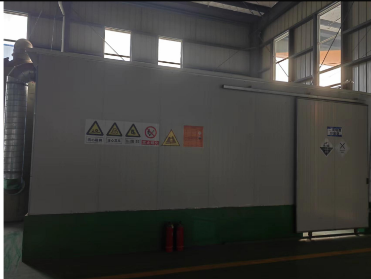
II类废铅蓄电池存放区
