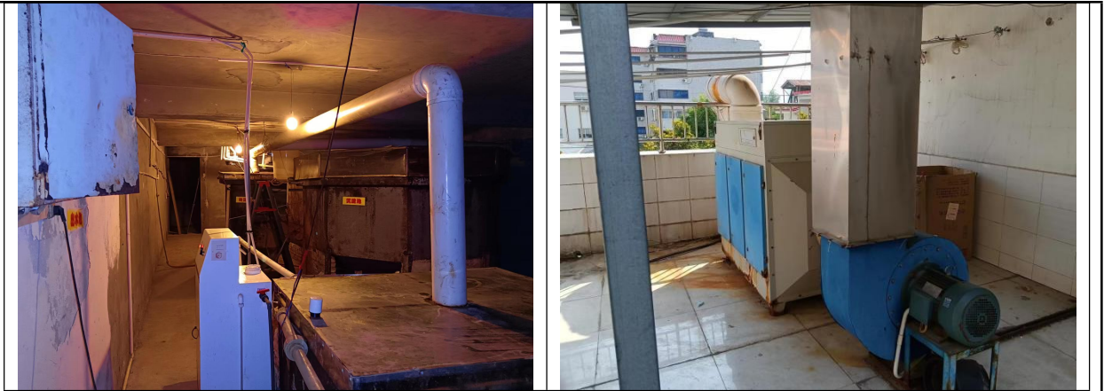
图 2-5 废气净化设施照片
