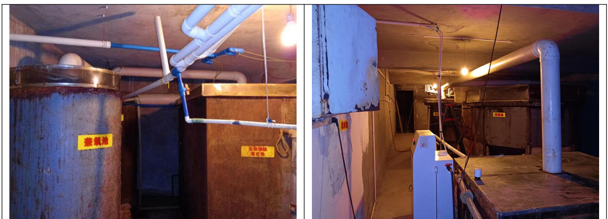
图 2-6 污水处理站现场照片
