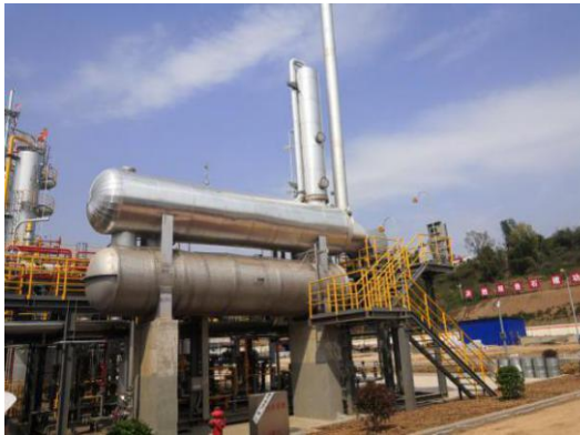
重沸气排气筒 (H=20m)
