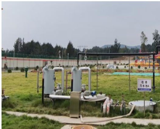
检修污水池（地理）
