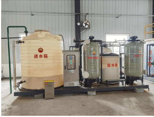
树脂交换装置
