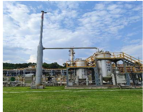
设置除臭排气筒 (H=15m)
