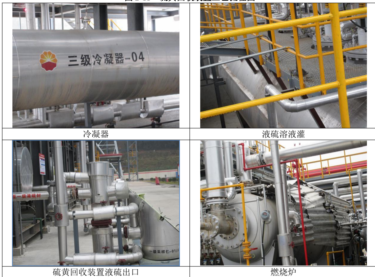
图 2-12 硫黄回收装置现场照片
