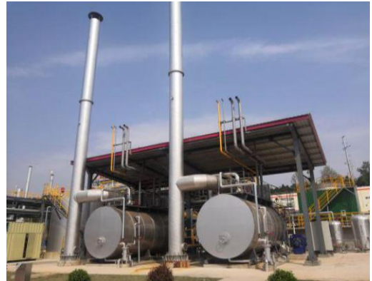
锅炉排气筒(H=20m, 2根, 一用一备)
