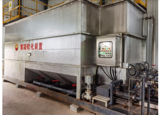
絮凝软化装置
