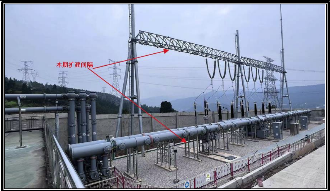
图 2-1 昭化 220kV 东向出线间隔现状图
