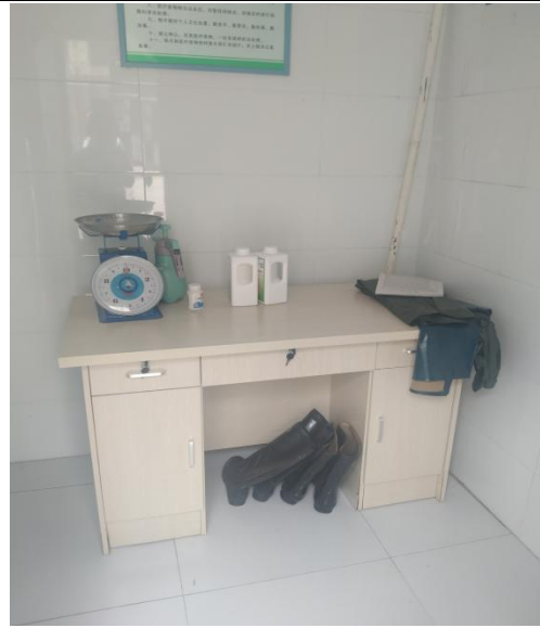
污水处理站投药间
