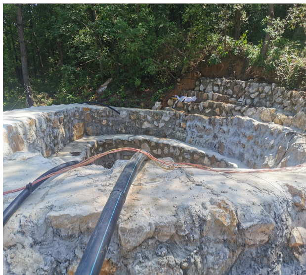
矿区高位水池（生产、防尘）
