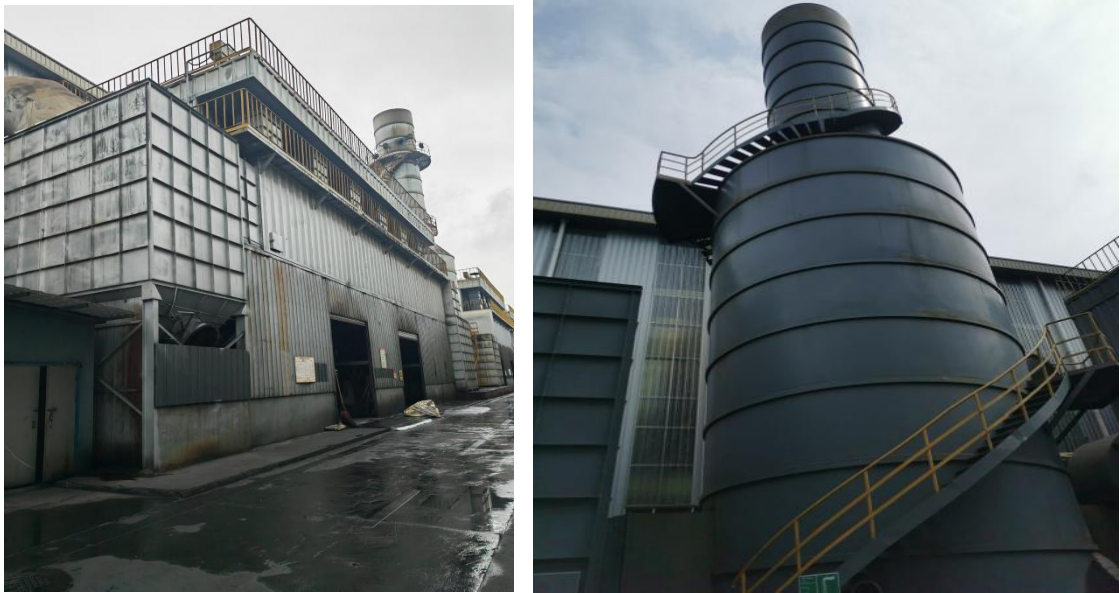
废气处理设施及其排气筒（DA002）
