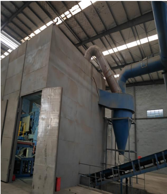
破碎设施封闭及集气管道
