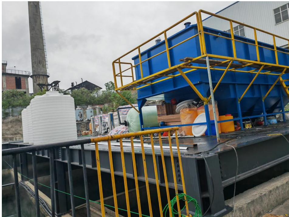
污水处理设施
