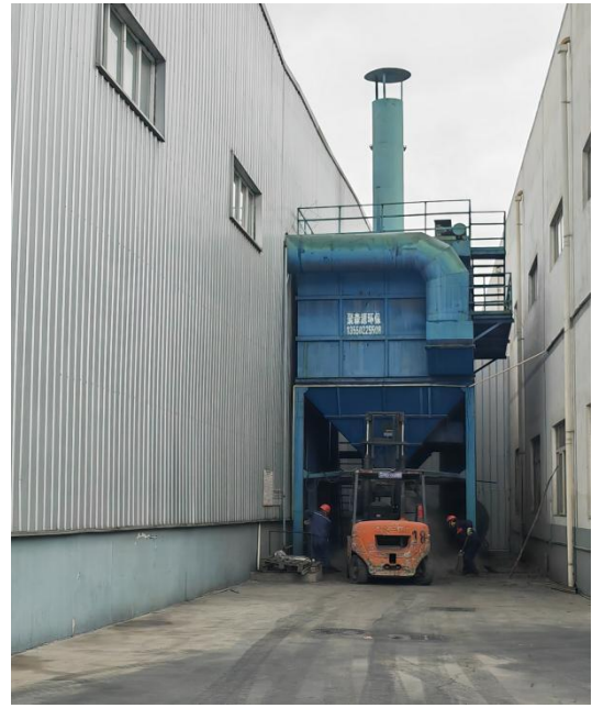
旋风布袋除尘及排气筒 (DA001)
