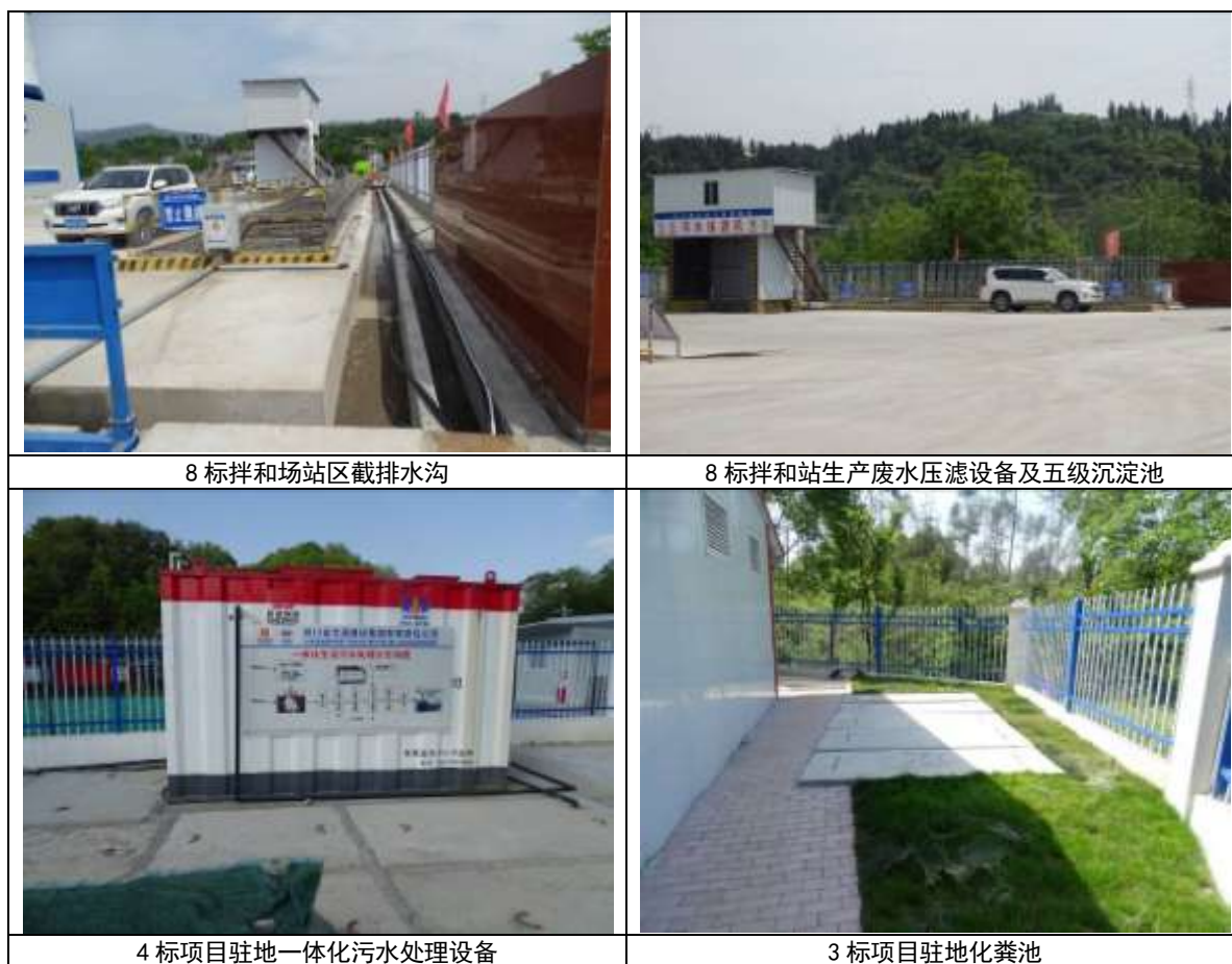
图 5.2.1-1 施工生产和生活污水处理设施情况
