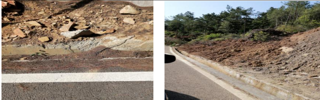
图 2-6 雨水导致坍塌冲路现状图
