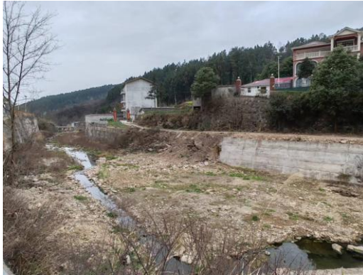
图 3-5 挡墙年久失修垮塌
