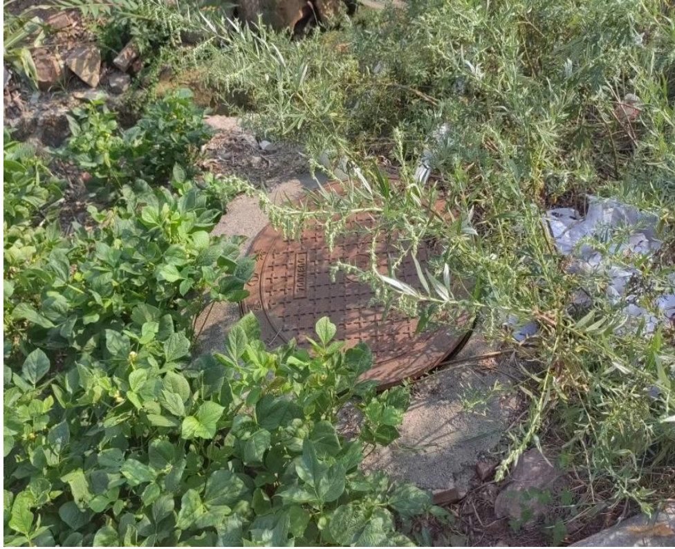
图 2-4 项目废水接管位置照片
