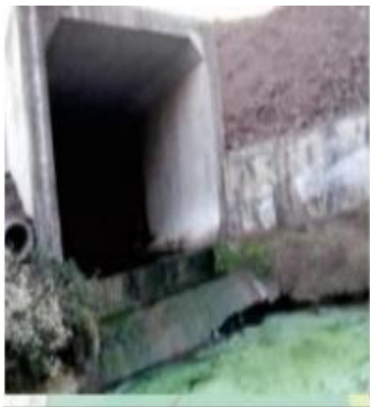
废水排水涵洞
