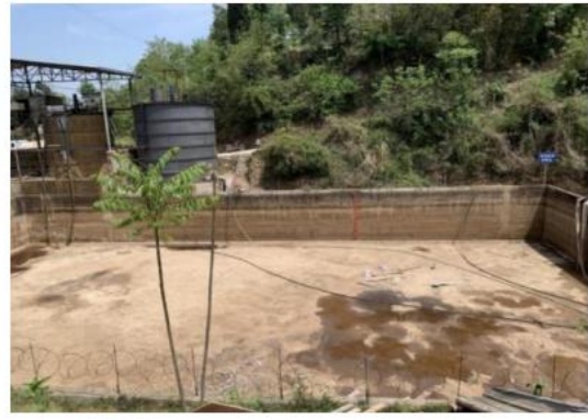
拦渣坝内侧渗滤液调节罐照片
