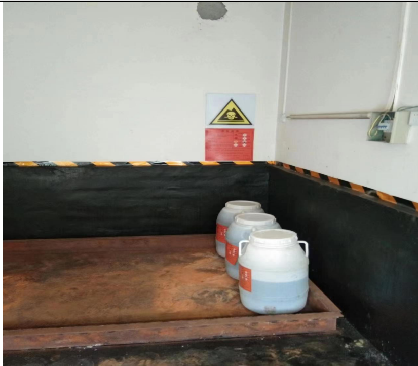
硫酸、液碱暂存间照片
