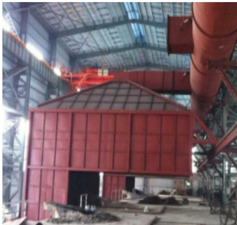
图4-2 类似项目大型吸尘房
