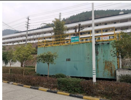
污水处理设施
