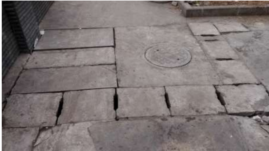
图2.6-3 食堂隔油沉淀池
