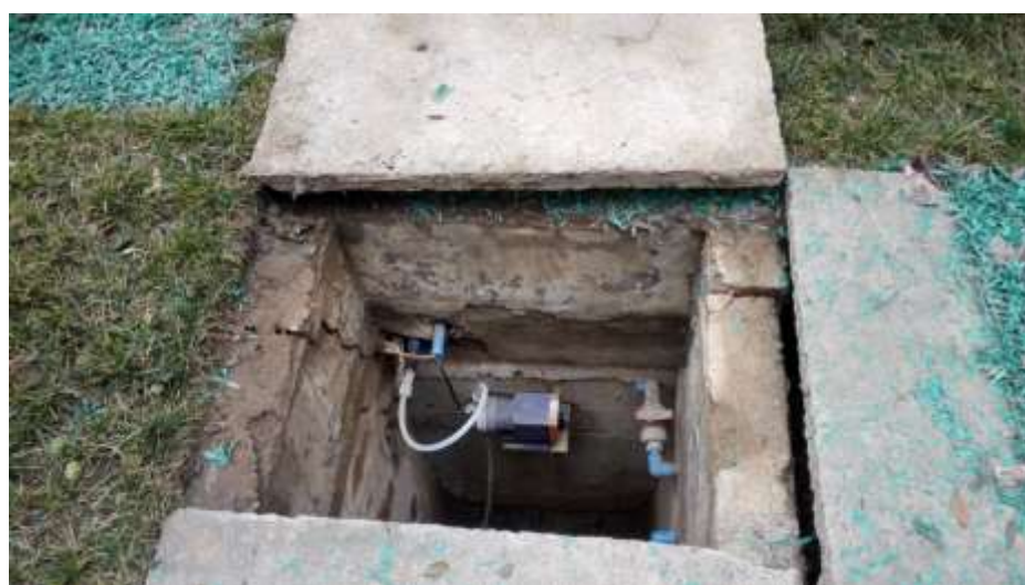
图2.6-7 污水处理站加药泵
