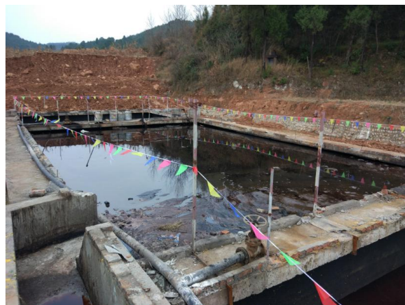
钻井废水未拉运处理
