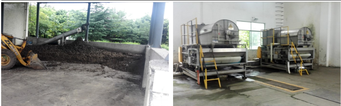
图 1-16 污泥脱水间及污泥堆棚
