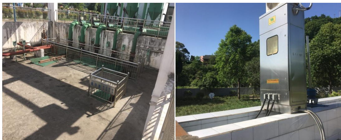
图 7-2 本项目调节池与在线监测装置现状图
