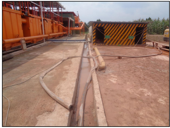
图 1-12 已建排水沟现状
