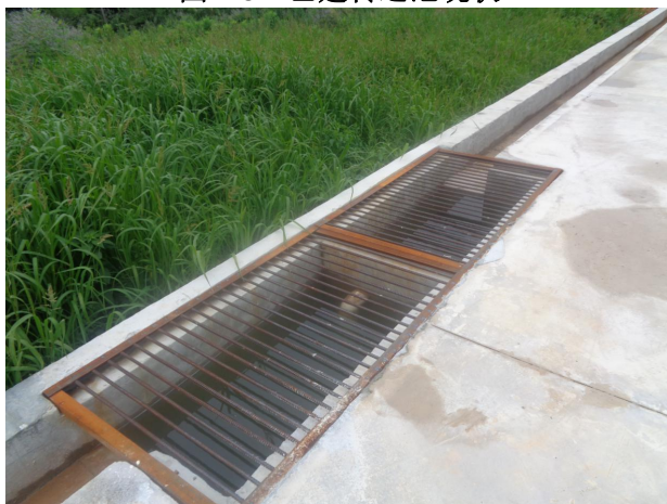
图 1-10 已建排水沟现状
