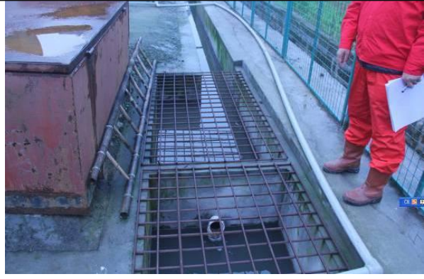
井场周边隔油池
